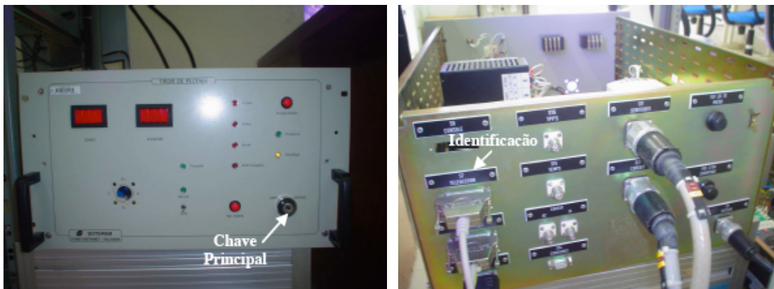
Figura 5: Vista do módulo de comando no rack da estação e a parte traseira com as conexões com outros módulos do SCR
