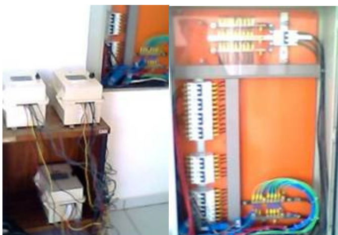
Figura 3-2. Imagens da instalação
