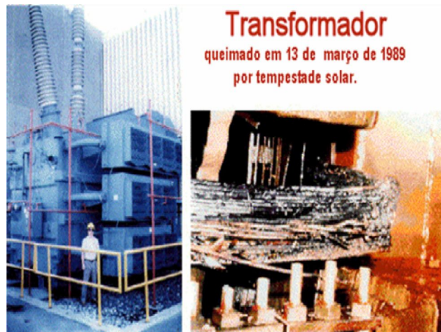
FIGURA 22: Transformador destruído, devido a uma tempestade geomagnética em Quebec no Canadá. FONTE: http://solarweek.org/wed_spaceweather.html .
