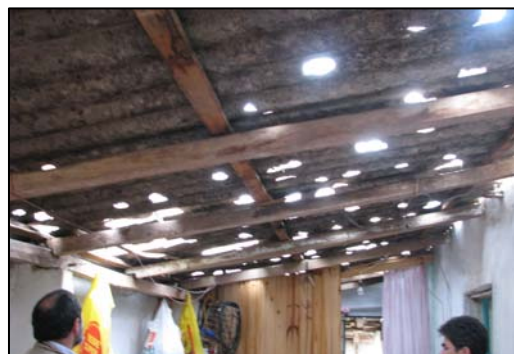
Figura 5: Garagem em São Sepé danificada pelo granizo do dia 11 de setembro. Foto: acervo GEODESASTRES-SUL
